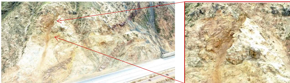
Рис. 1. Идентификация трещин и неустойчивых блоков на склоне.
